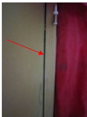
Figure 9 : Absence de joint sur le dormant de la porte du couloir - Coriolis
